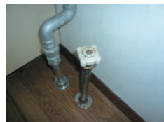
※写真1【止水栓(給水栓)】
